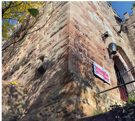
Abb. 16 = Blick von Südosten auf das Burgportal; im Vordergrund der Baufehler mit der Auskragung für den Riegelbalken des Tores
